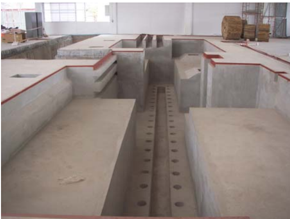
รูปที่ 15 แสดงเมื่อบ่อหล่อส่วนผนังและพื้นเตรียมติดตั้งเครื่องจักร และวางลำเลียงวัตถุดิบ
