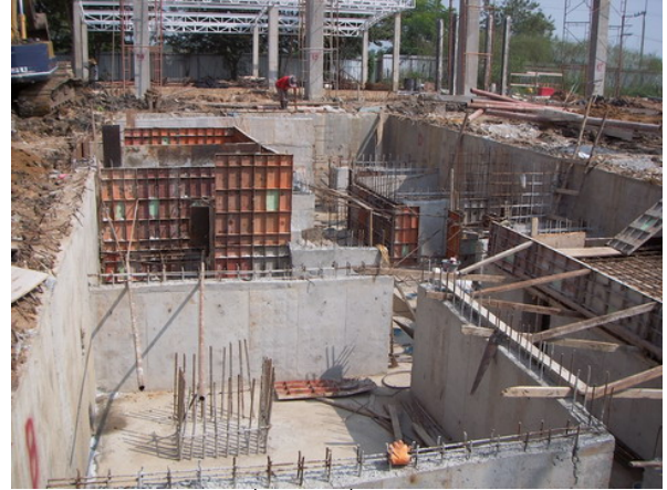
รูปที่ 14 แสดงผนังที่ไว้รับเครื่องจักรและสามารถช่วยในการค้ำยันบ่อเมื่อถอดค้ำยันชั่วคราวออก
