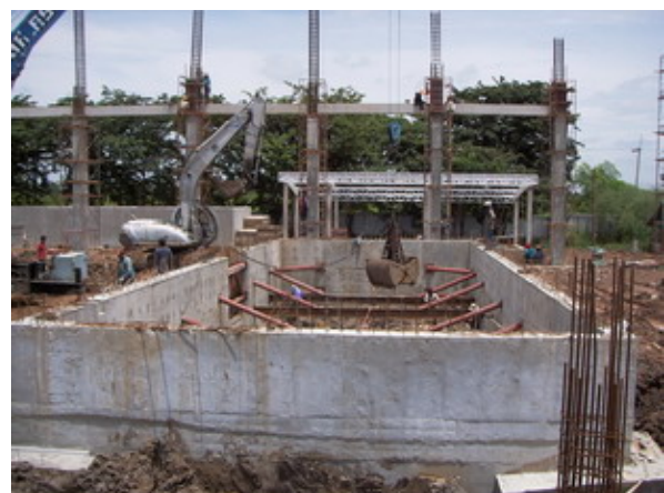
รูปที่ 10 เมื่อถมบ่อโดยใช้เครื่องมือขุดแบบกบทยและได้ทำการค้ำยันบางส่วน และบริเวณมุมบ่อมีโครงสร้างนำ
