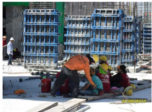
รูปที่ 1. เวลาไร้ประสิทธิผล (Ineffective Time) ซึ่งเกิดจากกรรมกรงานเหล็กรอให้งานไม้แล้วเสร็จก่อน
