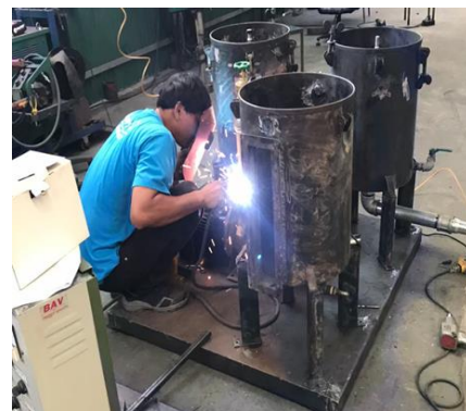
รูปที่ 6 ประกอบถังพักน้ำและถังกรองน้ำตามตำแหน่งที่ได้ออกแบบไว้
