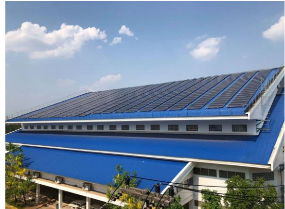
รูปที่ 4 ระบบผลิตไฟฟ้าพลังงานแสงอาทิตย์แบบ ติดตั้งบนหลังคา ขนาด 250 กิโลวัตต์ มหาวิทยาลัยภาค ตะวันออกเฉียงเหนือ ขอนแก่น
